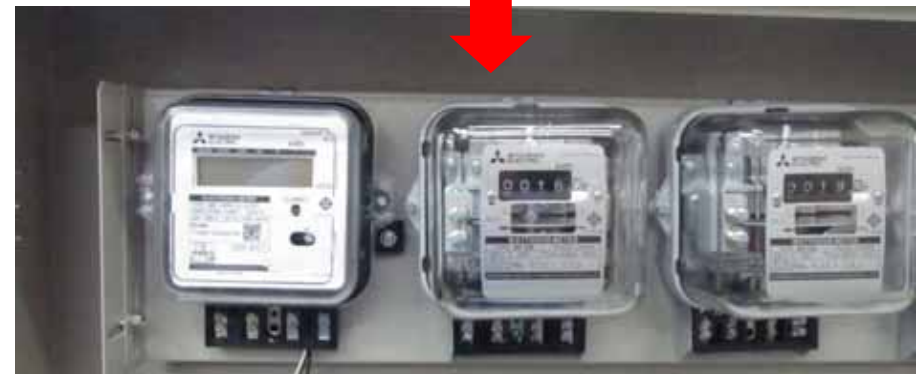
นำมิเตอร์ SX1 ติดตั้งแทนตรงตำแหน่งมิเตอร์เดิม
