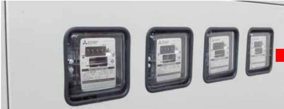
ตู้มิเตอร์เดิม (จานหมุน)
